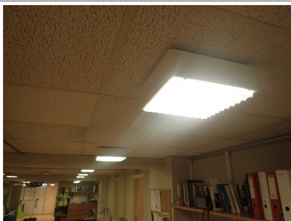
442-01 Belysning med lysstoffrør og kompaktlysrør i fellesarealer. Generelt fra 86.
