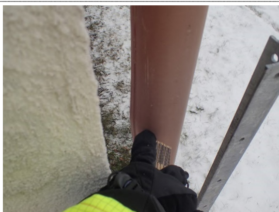
265-01 Frostsprengt nedløpsrør i hjørne mot nord.
