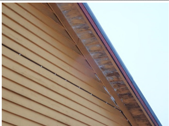
261-01 Rim og isdannelse i underkant av raft, mot sørvest.
