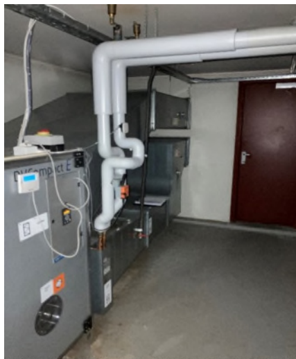
265-01 Eldre ventilasjonsaggregat på loft, forsyner pasieltrum i nyeste del av bygget.
