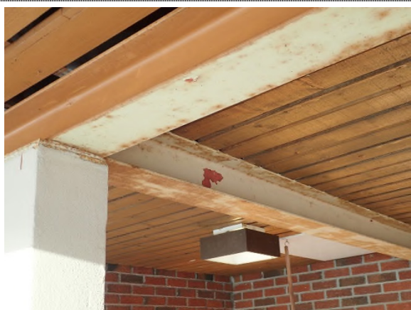
223-01 Gryende rustdannelse på stålbejelker over terrasser mot sør.
