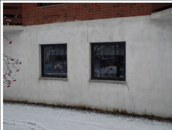
216-02 Riss og sprekker i mur, mot vest.
