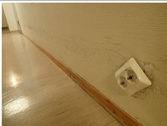
246-05 Typisk skade på overflater i korridorer.
