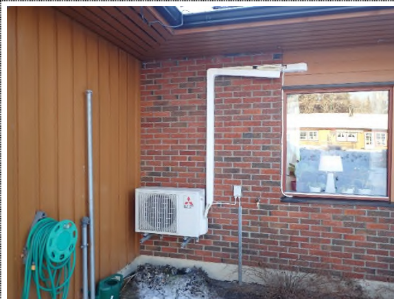
325-01 Løst og delvis manglende deksel rundt kanaler til varmepumpe.
