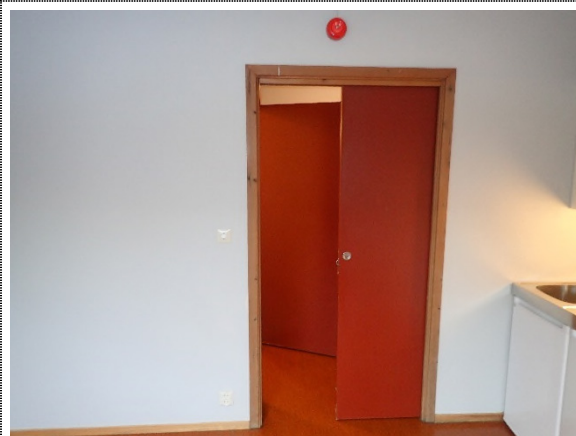
244-03 Skyvedører mellom beboerrom og gang med bruksslitasje og noe skader.
