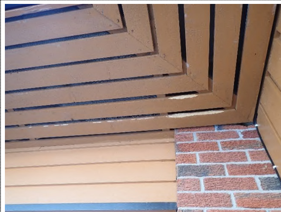
265-02 Manglende fluenetting over kasseledning fører til angrep fra fugler.
