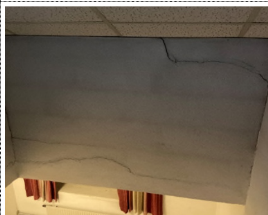
231-04 Tydelige oppsprekninger i murverk rundt trapperom mot nord, eldste del av bygget.
