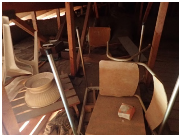
261-01 Unødvendig lagring på kaldloft.
