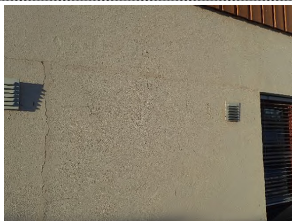
231-01 Riss og sprekker, samt avskalling av kjellermur mot øst.
