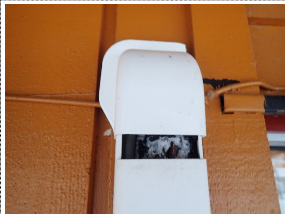
325-01 Løst deksel på ledninger til varmepumpe, fører til angrep fra fugler.
