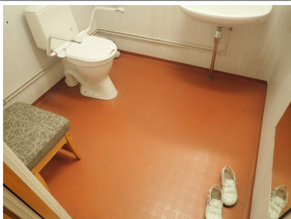
255-02 Våtromsbelegg på bad: varierende tilstand. Generell bruksslitasje.
