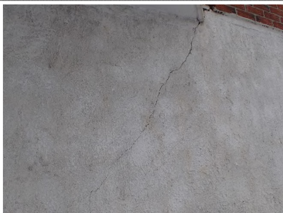
216-01 Flere riss og sprekke-dannelser i mur rundt underetasje, mot vest
