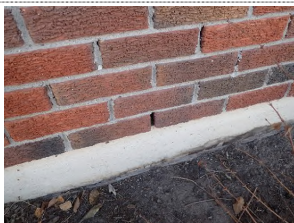
217-02 Ikke kontakt mellom overgangslist og grunnmursplast, mot nord.
