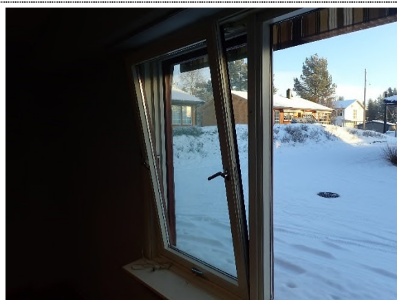
234-02 Vinduer er trekkfulle og tunge å åpne/ lukke.
