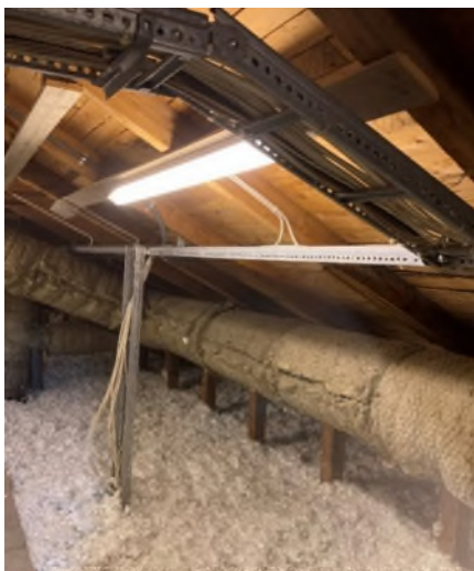
362-01 Eksempel på kanalføring av ventilasjon, på loft.
