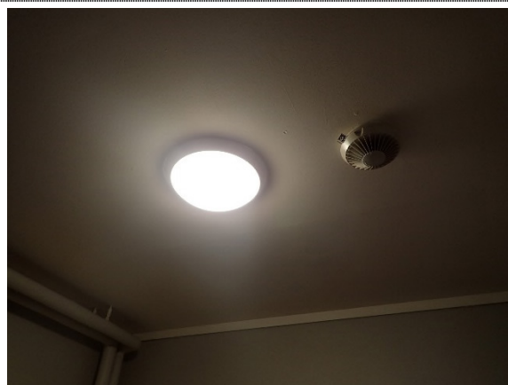
442-02 Kompaktlysrør på gang, beboerrom.
