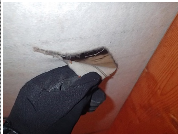
262-01 Skade på duk i undertaket. Mot vest.
