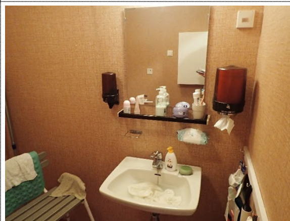
315-02 Sanitærinstallasjoner fra byggeår.
