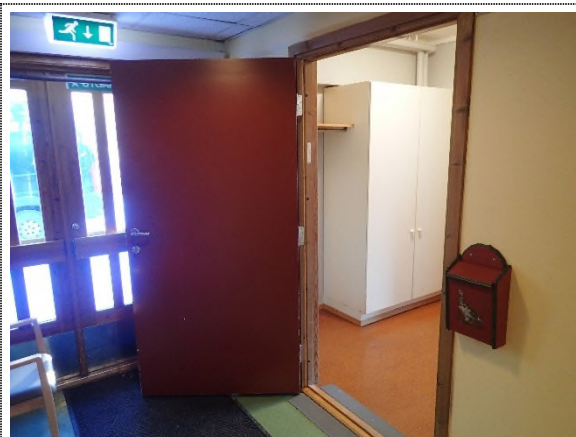
244-01 Dører mellom beboerrom og korridor er fra byggeår. Dører bruksslitasje og noe skader.
