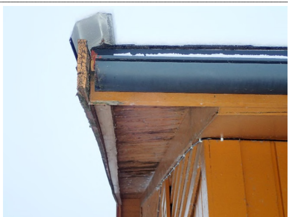
265-03 Manglende endebeslag på takrenne kan føre til råteskade på vindski.
