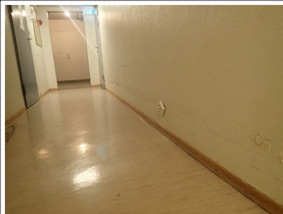
255-03 Gulvbelegg i fellesarealer og korridorer i varierende tilstand, men noe slitasje.
