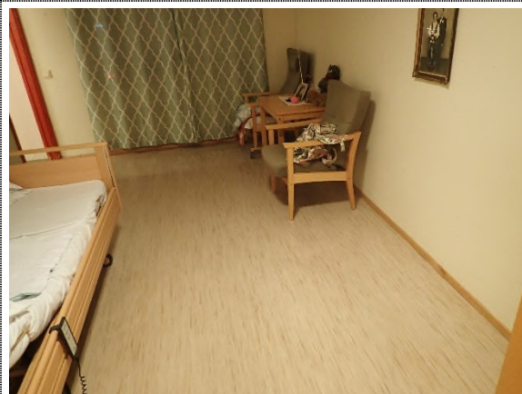
255-01 Gulvbelegg på beboerrom. Mye bra belegg, men generell bruksslitasje.
