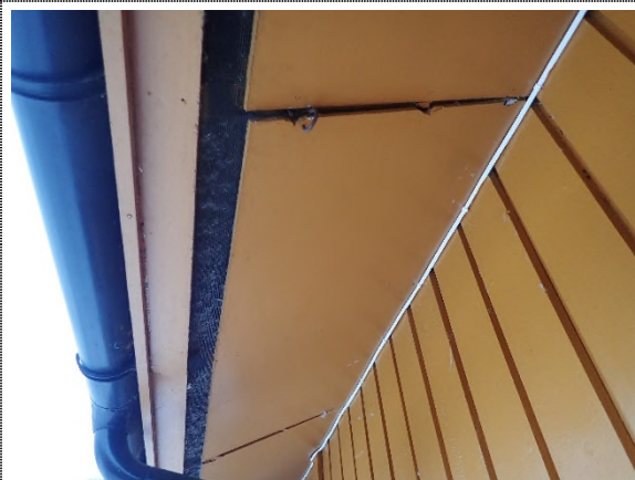
265-02 Flere løse, og stedvis manglende plater i raftekasser rundt bygget.
