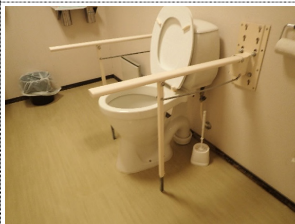
315-01 Sanitærutstyr i første byggetrinn er i hovedsak fra byggeår 82. Eksempel fra fellestoalett.
