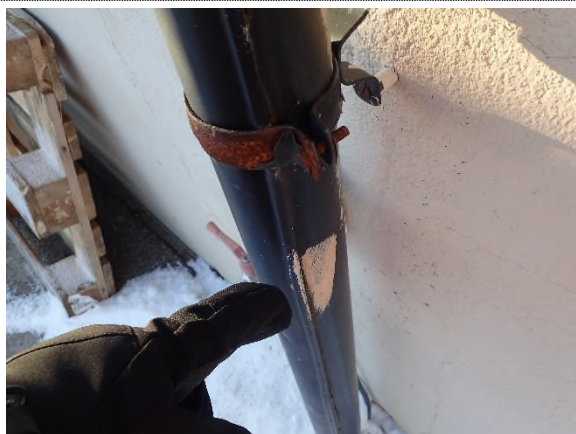
265-01 Frostsprenkt nedløpsrør, mot øst.
