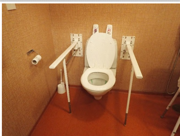
315-01 Sanitærinstallasjoner fra byggeår.
