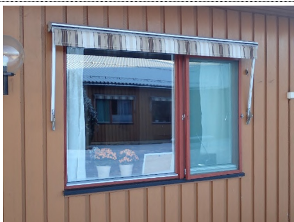
234-01 Vinduer fra byggeår og har nådd forventet levetid.
