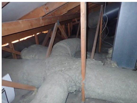
362-01 Kanalnett er plassert over loft.
