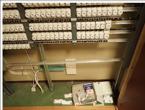
433-02 Fordelingstavle med gamle skrusikringer.
