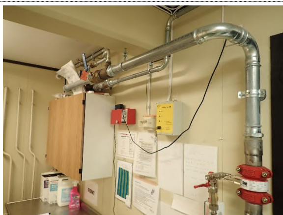
332-01 Sprinkleranlegg er ikke operativt.
