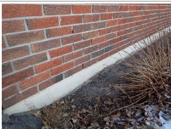
217-01 Glippe mellom grunnmursplast og overgangslist.
