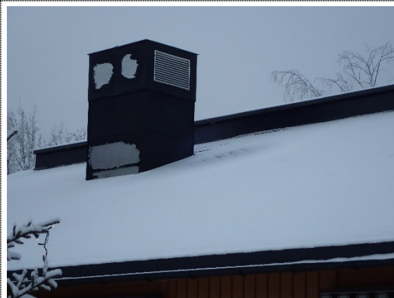
263-01 Avskalling av lakk på luftehatt.
