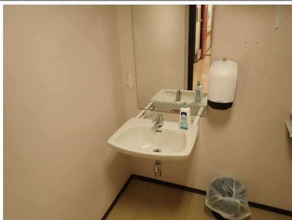
315-02 Eksempel på sanitærutstyr fra 82. Eksempel fra fellesoalett.
