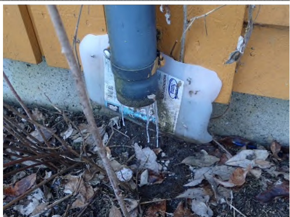
265-01 Mot nord mangler det flere utkastere på nedløpsrør.
