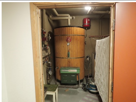
315-03 Varmtvannsbereider er fra byggeår.
