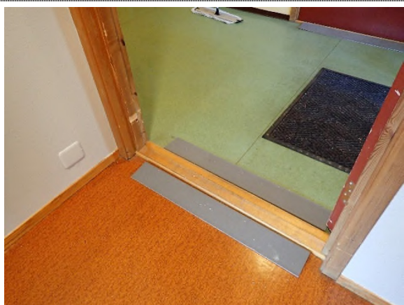
244-02 Dører til beboerrom med mye bruksslitasje og skader.
