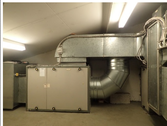
365-01 Ventilasjonsaggregat er fra byggeår, og har nådd forventet levetid.
