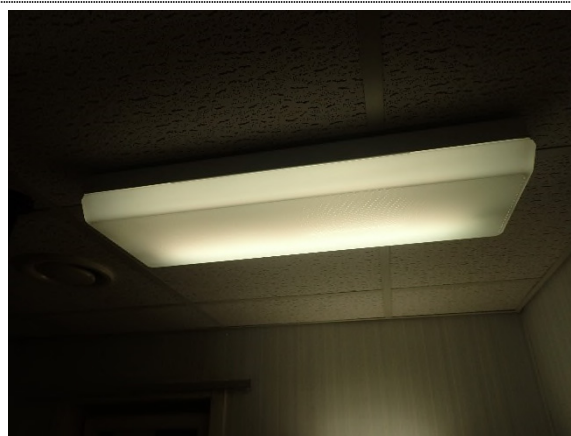
442-02 Beløsning med lysstoffrør i beboerrom og bad. Generelt fra 86.
