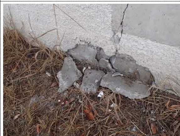
231-02 Vestikale og skrå sprekk-dannelser mot vest.
